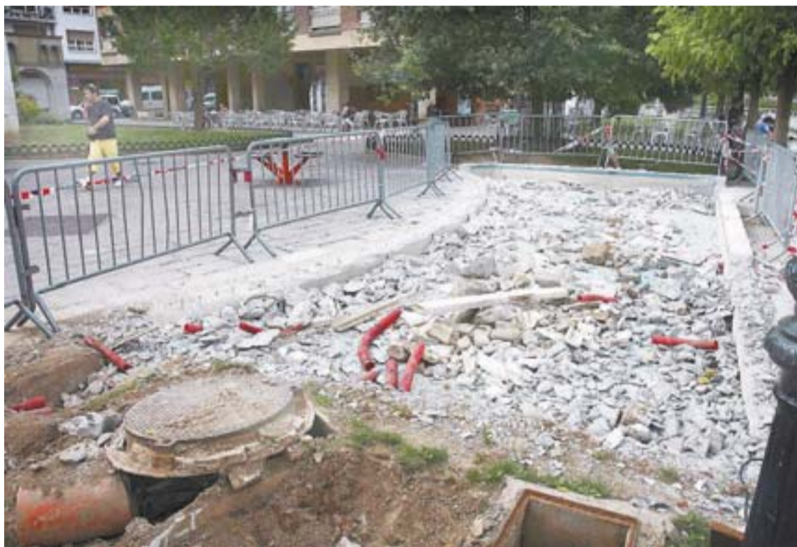
Restos. Cascotes ocupan el lugar que albergaba la fuente ornamental, ahora demolida. ✚ AITOR
